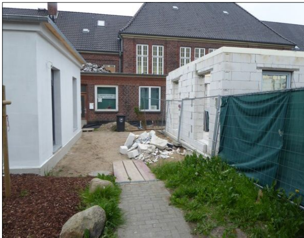
Abbildung 38: Der Weg zur Bahnmissionsmission in Schleswig war durch die Baustelle und Bauschutt zwischen dem Gebäude und dem Hausbahnsteig stark beeinträchtigt und nicht mehr barrierefrei.
