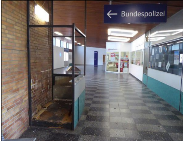
Abbildung 37: Dieser Einbau in der Bahnhofshalle von Elmshorn beeinträchtigte nicht nur das Erscheinungsbild sondern stellte auch eine potenzielle Unfallgefahr dar.
