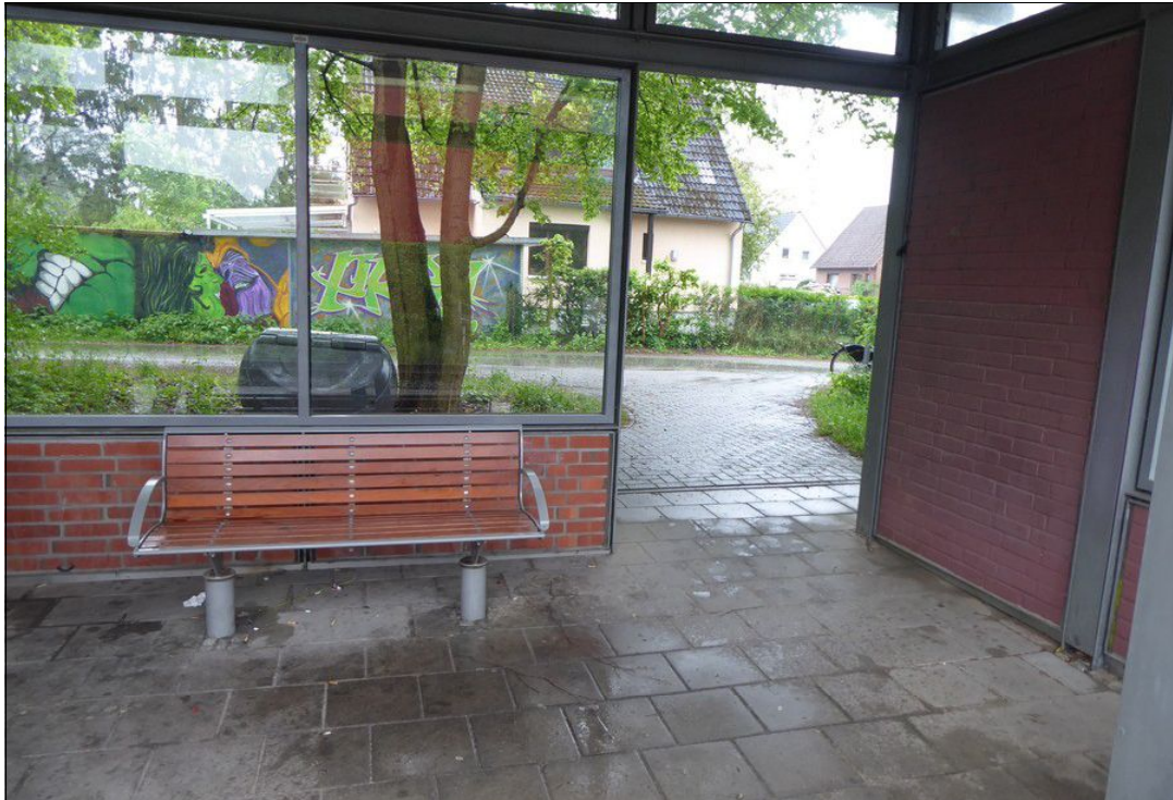
Lübeck-St. Jürgen: Bahnhof an der Strecke Lübeck - Bad Kleinen. Das Dach der Wartehalle war im zentralen Wartebereich undicht.
