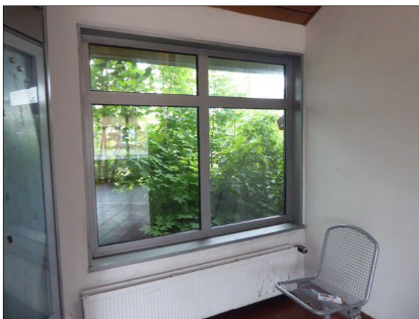
Abbildung 39: Das Fenster zur Gleisseite des Pavillons von Owschlag war zugewachsen.
