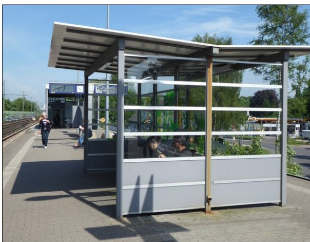
Abbildung 9: Der Wasserablauf dieses Unterstandes in Halstenbek ist defekt. Die Rostspuren zeigen, dass das Wasser außen am Fallrohr entlang läuft.
