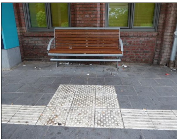
Abbildung 12: Der Wartebereich unter dem Vordach an Gleis 1 in Meldorf war stark verschmutzt.
