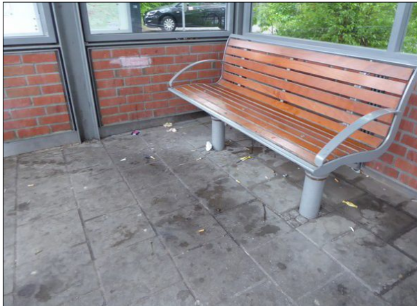
Abbildung 7: Ungewöhnlich viele Wetterschutzeinrichtungen auf den Bahnsteigen waren stark verschmutzt. Auch auf den Wartebereich der Wartehalle in Lübeck-St. Jürgen traf das zu.
