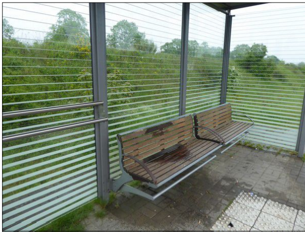
Abbildung 13: Die Unterstände an Gleis 4 in Büchen sind beide undicht. Daher sind einzelne Sitzbänke bei Regen nicht nutzbar.
