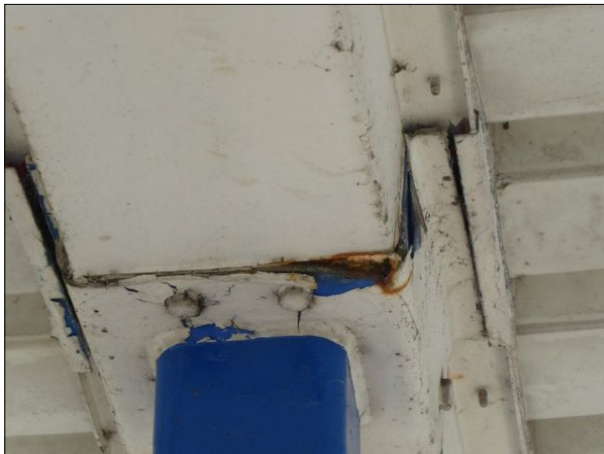
Abbildung 8: Das Bahnsteigdach in Ellerau weist Lackschäden und kleine Roststellen auf. Aus den Dachkanten tropft stellenweise Wasser.
