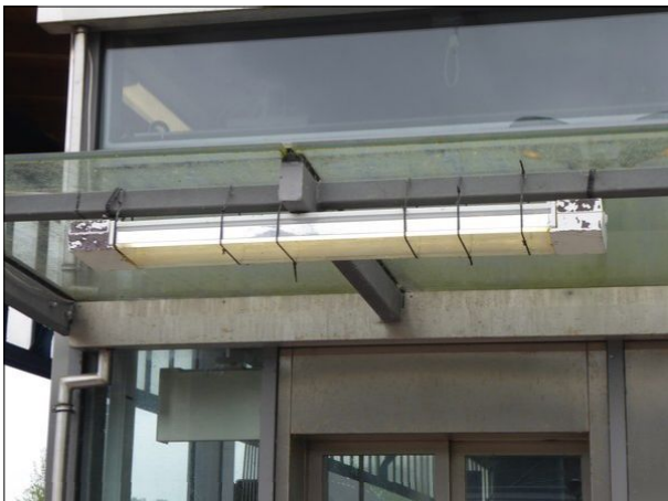
Abbildung 50: Seit dem Einbau der Aufzüge im Jahr 2010 ist die Leuchte am Vordach des Zugangs auf dem Bahnsteig der Gleise 4/5 in Flensburg nur provisorisch befestigt.
