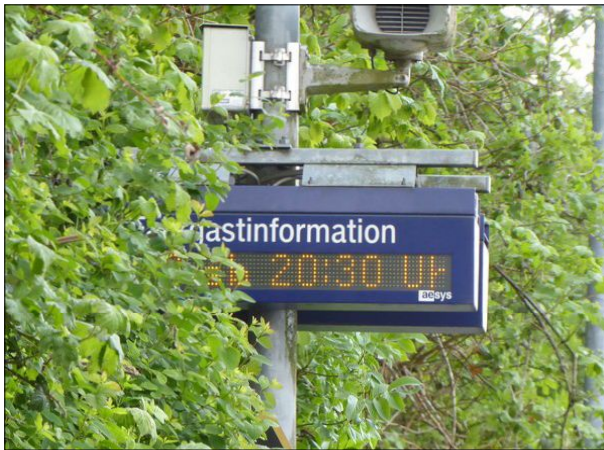
Abbildung 55: Die Befestigung des DSA an Gleis 2 in Bad Segeberg in der Mitte eines Mastes ist ungünstig. Ein Ausleger würde die Sichtbarkeit der Informationen verbessern.
