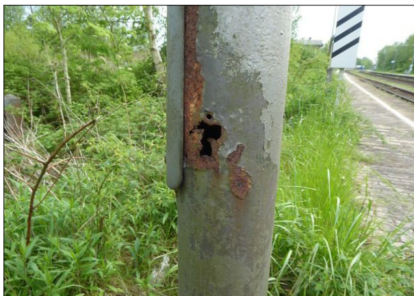
Abbildung 51: Deutliche Korrosionsschäden weisen einige Lichtmasten in Friedrichstadt an Gleis 1 auf.
