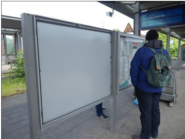
Abbildung 34: Neben der schon im Winter fehlenden Vitrinenscheibe in Husum an Gleis 5 wurde nun noch ein vergleichbarer Schaden an Gleis 3 verzeichnet.
