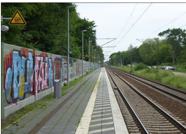
Abbildung 27: Mittlerweile ist die Lärmschutzwand in Prisdorf auf ganzer Länge beschmiert. Das Erscheinungsbild wird erheblich beeinträchtigt.
