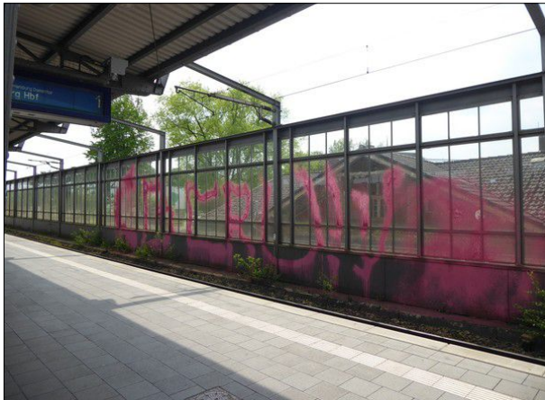
Abbildung 25: Seit mehreren Monaten ist die Wetterschutzwand im Bahnhof Rendsburg großflächig beschmiert.
