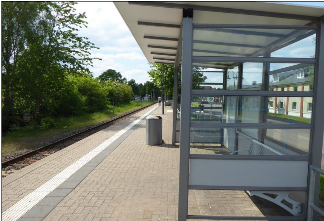
Aukrug: Haltepunkt an der Strecke Neumünster - Heide. Alleine am östlichen Unterstand waren Schäden an der Brüstung, Rost an der Bank, eine verschmutzte Bahnsteigoberfläche und ein mit Beschädigung des Pflasters aus der Halterung gerissener Abfallbehälter zu verzeichnen.
